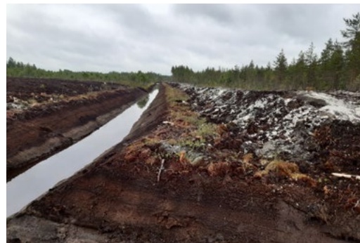
Oulun Välimaalla vesienpujotuslaitoksen kaivuutöiden yhteydessä havaittu hapan sulfaattimaa kalkittiin happamien valumavesien synnyn estämiseksi.
