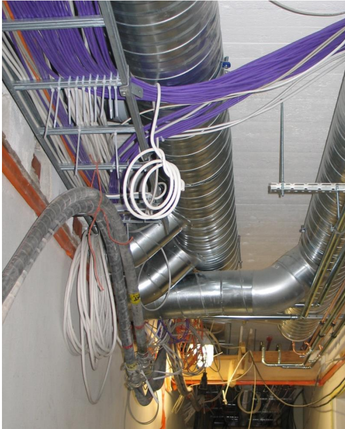
Sähkö- ja tietoliikennekaapelointeja käytävän katossa.
