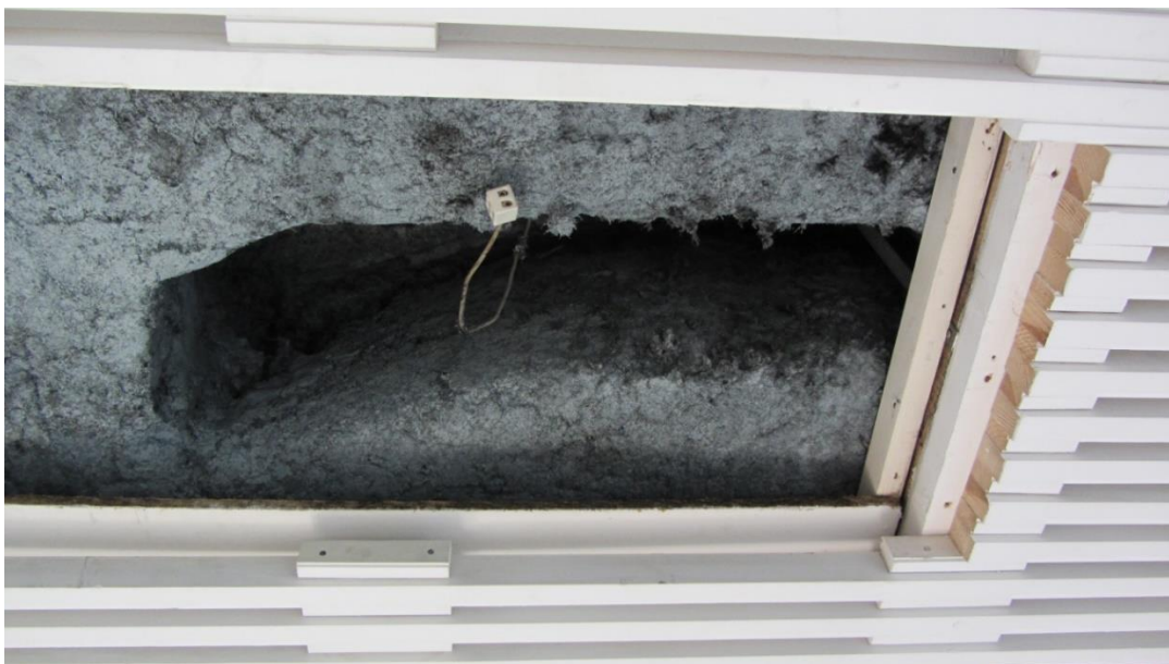
Ruiskuasbestilla eristettyjä ilmanvaihtokanavia.
