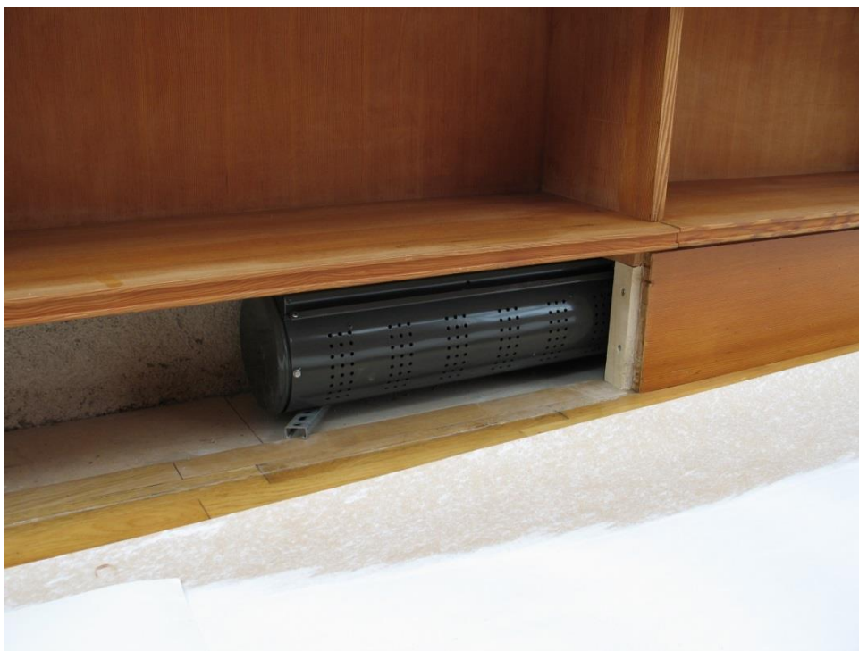
Reikäkanava piilotettuna sokkelitilaan.
