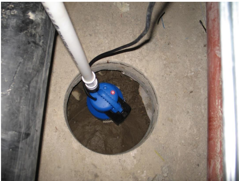
Uppopumppu joka käynnistyy jos anturi havaitsee kosteutta.
