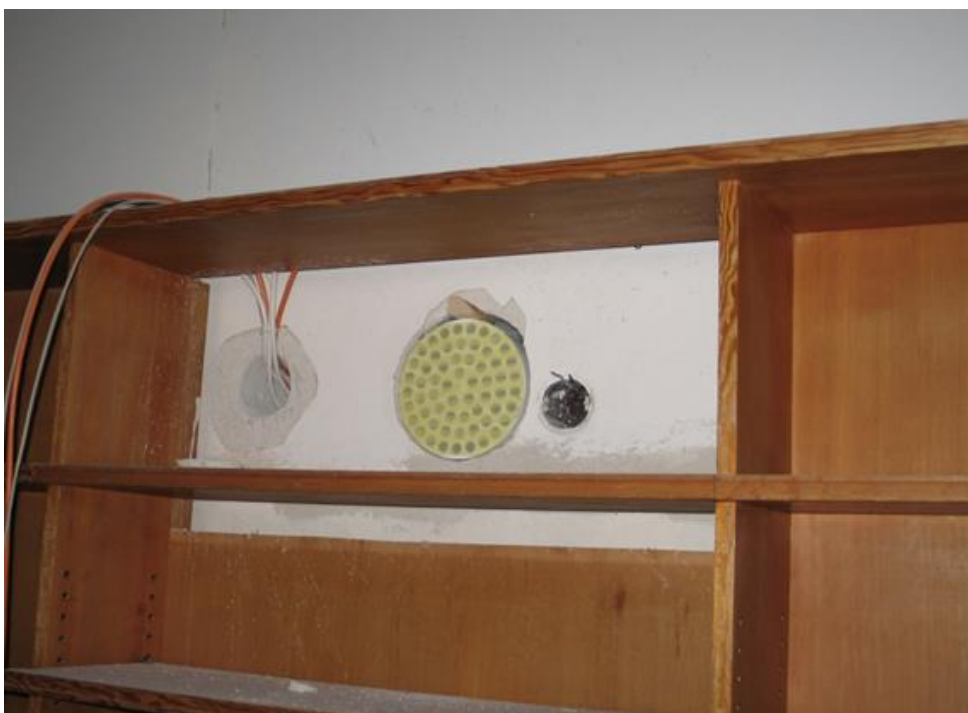
Kirjahyllyjen takana on ilmapäli josta poistoilma johdetaan ilmanvaihtokoneen kautta ulos.
