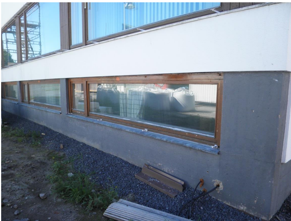
Ikkunapellitykset ennen kunnostusta.
