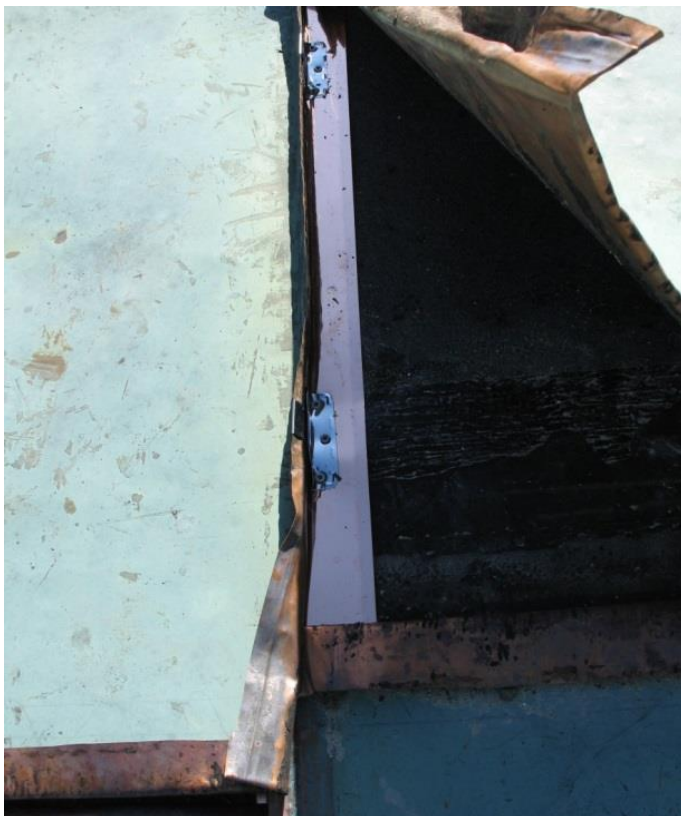
Kuvassa uudet kiinnitysklemmarit ja niiden alla kupariliuska.
