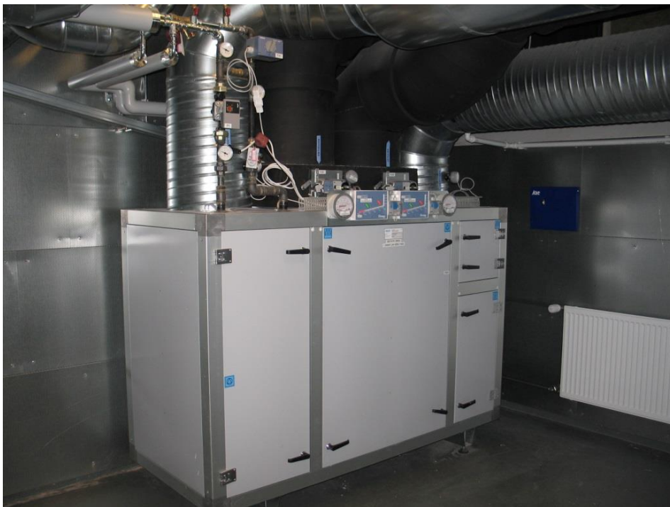
Yksi uusista ilmanvaihtokoneista.
