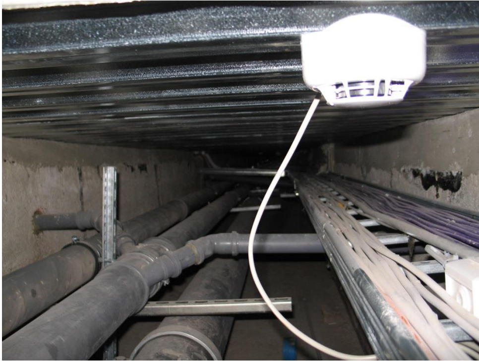
Kuva putkikanaalin sisältä. Yläreunassa paloilmaisin.
