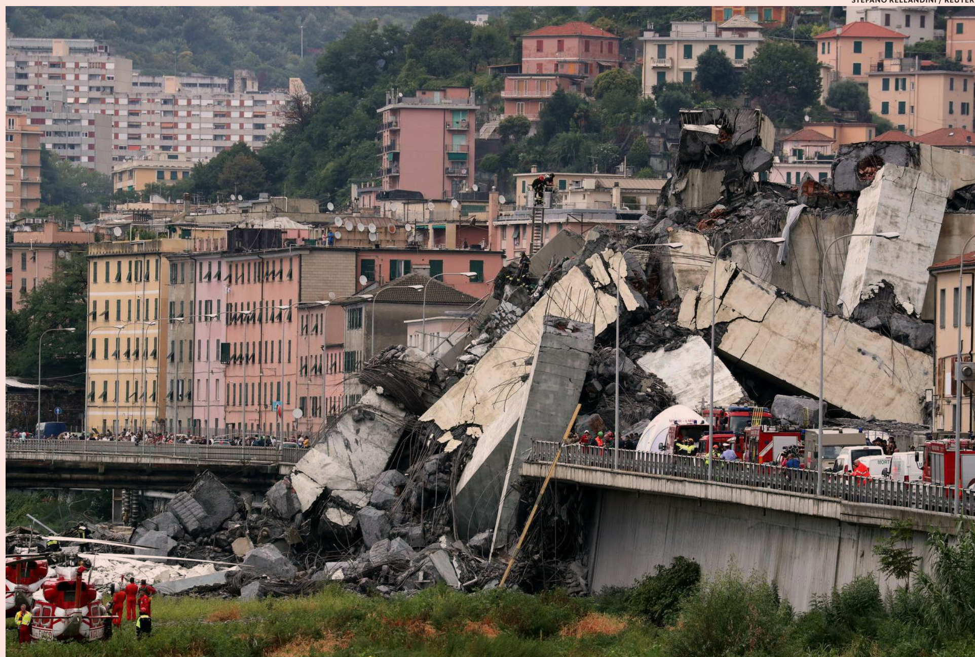
Moottoritien sillan äkillinen romahtus Italian Genovassa aiheutti kymmenien ihmisten kuoleman vuoden 2018 elokuussa. Silta oli niin kutsuttu vinoköysisilta. Samaa tyyppiä on myös Kruunuvoensilta.
