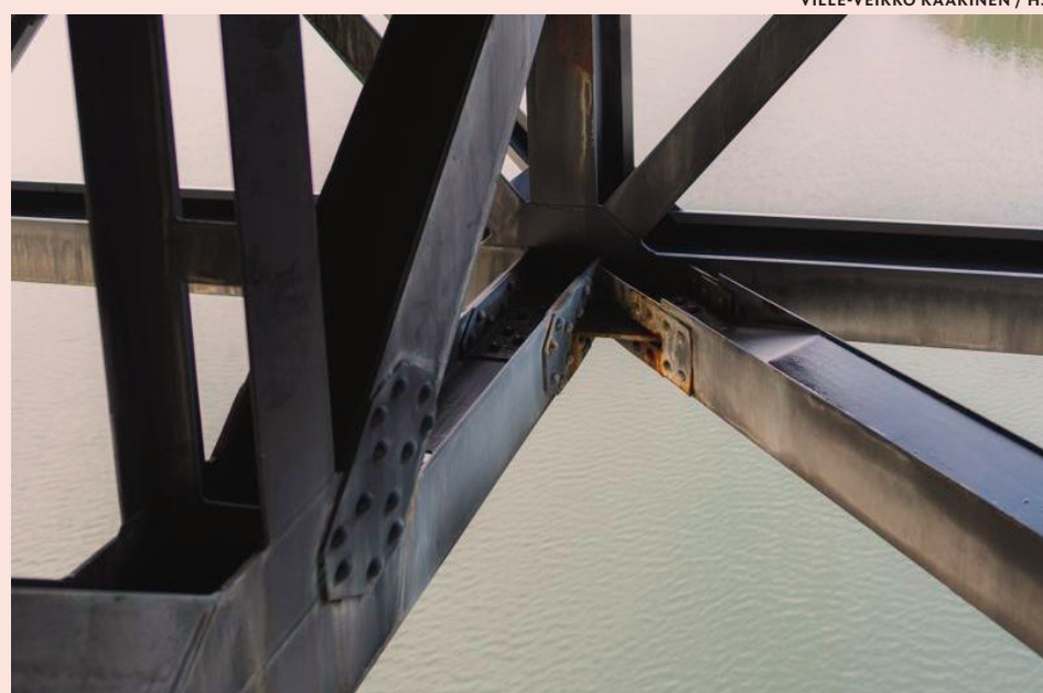
Kirjalansalmen sillan niittiliitokset ovat ruostuneet. Kunto on heikentynyt odotettua nopeammin kesän aikana, ja lisää rajoituksia on tulossa.
