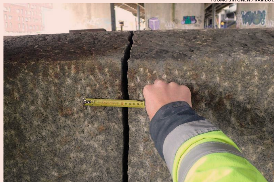
Kulosaaren sillan välituissa on pahoja halkeamia. Vaurioituneiden välitukien kohdalla on havaittu painaumia meren pohjassa
